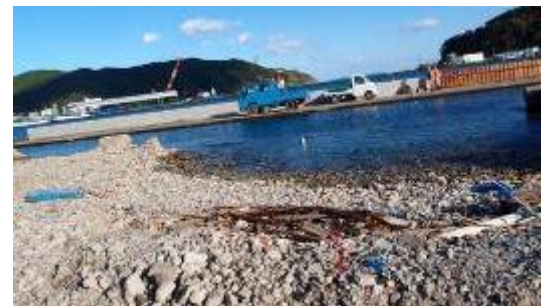
地盤沈下で水没する岸壁～女川漁港
